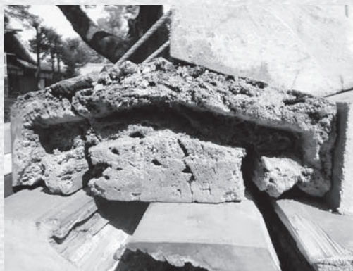
劣化著しい甲板
